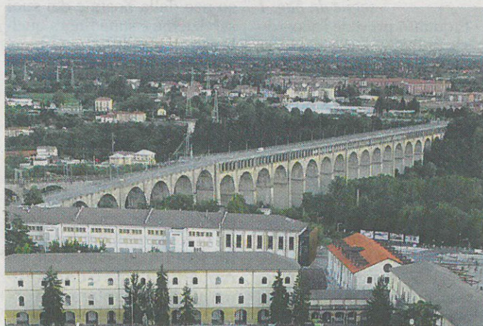
Cuneo - Il viadotto Soleri da tempo attende una manutenzione.
